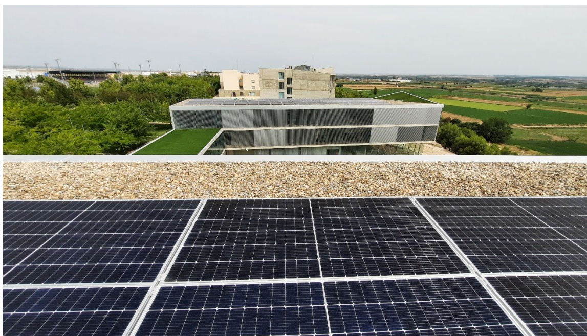
Imagen 11. Cubierta fotovoltaica. Edificio Estudiantes.
